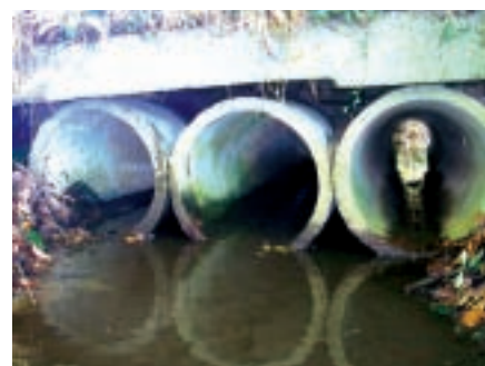
A l'étranglement, franchissement impossible pour le poisson
