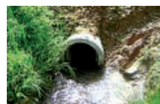
Obstruction par les encombres, inondation des parcelles et érosion en aval
