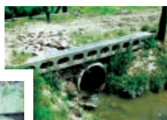
Enfoncement trop faible
